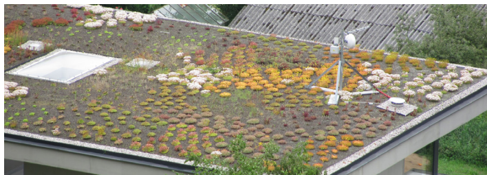
Extenzivní zelená střecha, Zruč nad Sázavou, Zdroj: autoři
